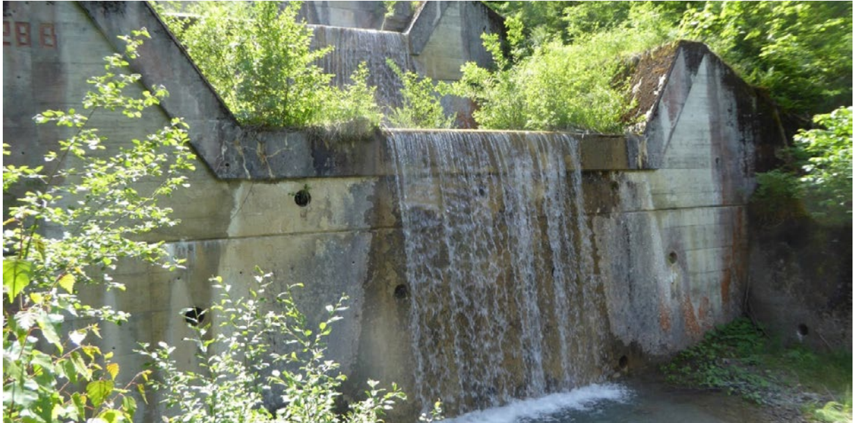
Sperregruppe 28, 29, Kote ca. 1000 m ü. M., in der Nähe der Guidalihittä; erbaut 1985/1986 als Ersatz der 1972 eingestürzten Steinblocksperrn
