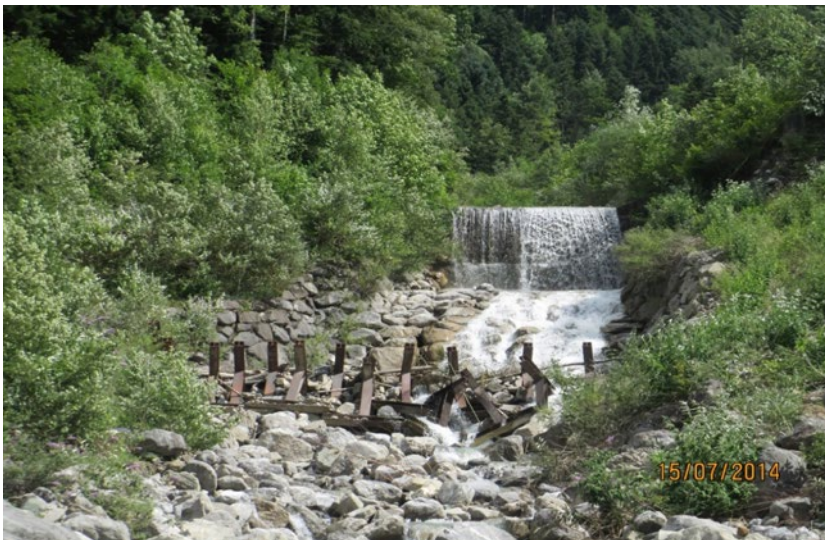
Einlaufsperrung, Kote 507 m ü. M., in die Umlagerungsstrecke oberhalb der Axenstrasse mit den Tetrapoden; Aufnahme 2014
